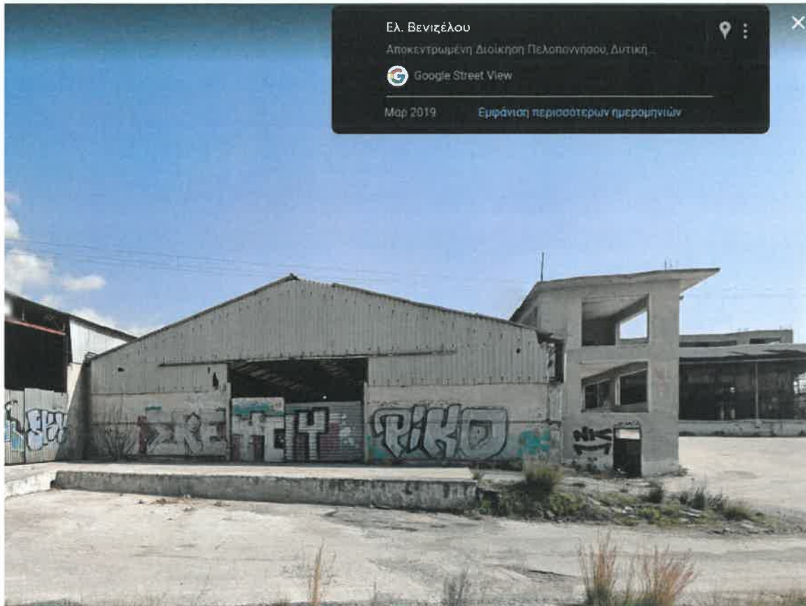
ΣΤ.29. Απόσπασμα φωτογραφίας(Μάρτιος 2019) του κτιρίου με την επικάλυψη και πλαγιοκαλυψη με κυματοειδή φύλλα αμιάντου (Πηγή google maps)
