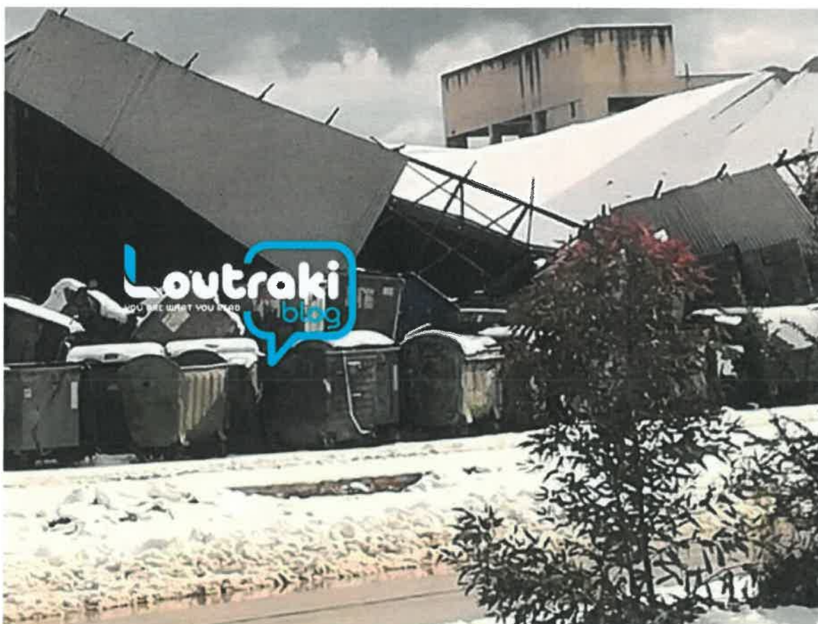
ΣΤ.25. Φωτογραφία που φαίνεται το κτίριο που έχει καταρρεύσει και οι κάδοι των απορριμμάτων (Πηγή: διαδικτυακή ιστοσελίδα)
