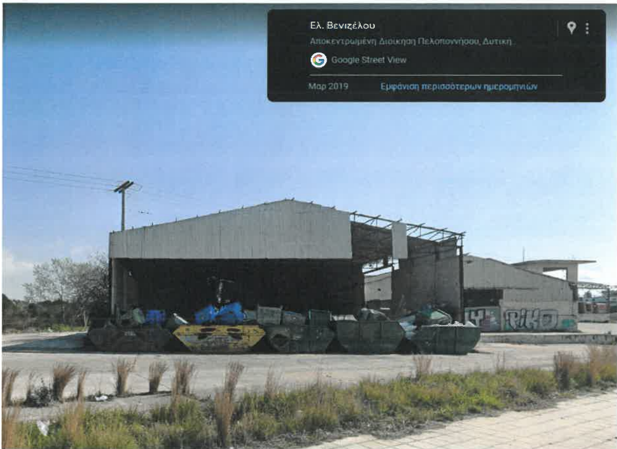
ΣΤ.23 . Φωτογραφία από όπου φαίνεται το κτίσμα πριν την κατάρρευση (Πηγή: διαδικτυακή ιστοσελίδα)
